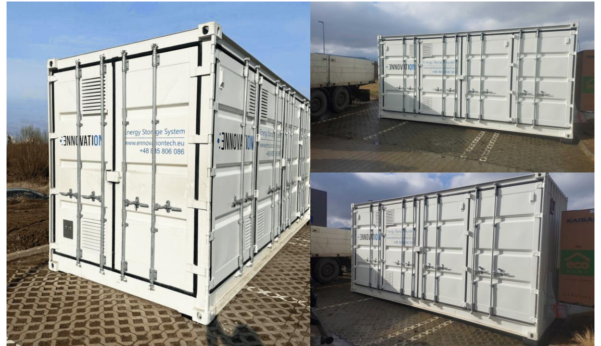
Centrum logistyczne - ME 0,25 MW 0,86 MWh
